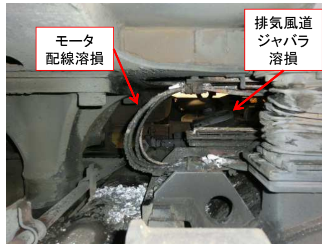
モータ配線・排気風道溶損
