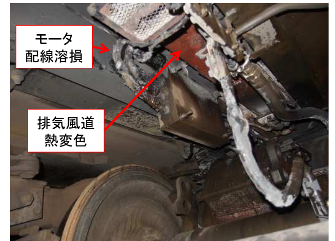
モータ配線溶損・排気風道熱変色
