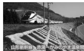
山形新幹線 赤湯~かみのやま温泉間 盛土のり面工(吹付枠工)
