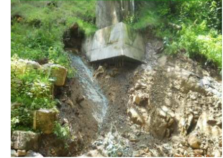
52k520m付近 羽根沢橋りょう洗掘
