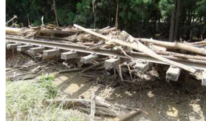
55k030m付近 路盤流失 55k060m付近 土砂流入
