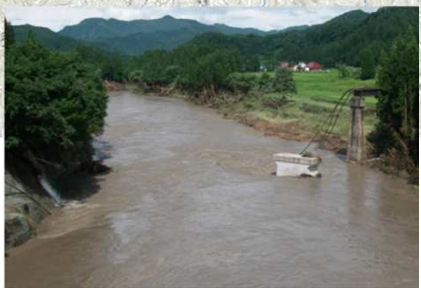
74k340m付近 第7只見川橋りょう桁流失
