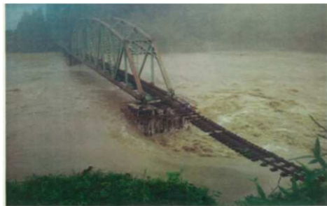
62k340m付近 第5只見川橋りょう桁流失
