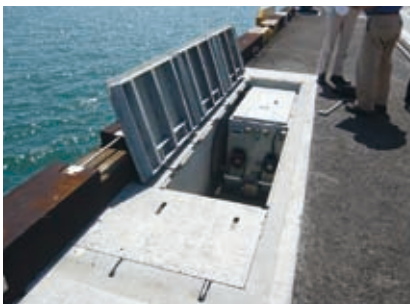
電源ケーブル接続箱 (写真3点提供：川崎汽船)
