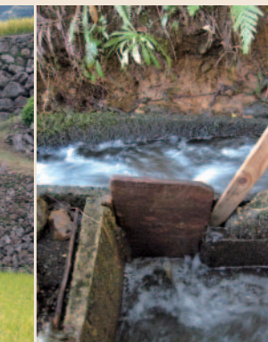
写真5 横溝水路に設けられた分水樹。ここから各棚田に送水される
