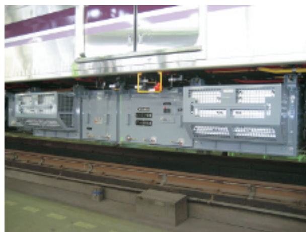
(写真9) 制御装置
