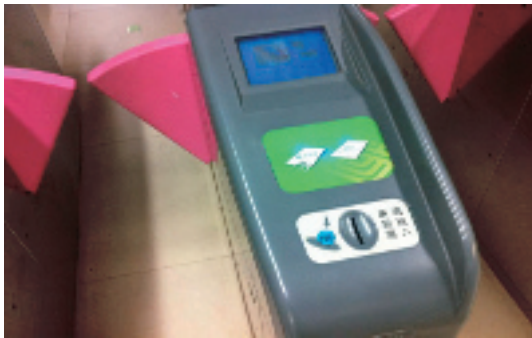
出場専用改札機（トークン投入口がある）
