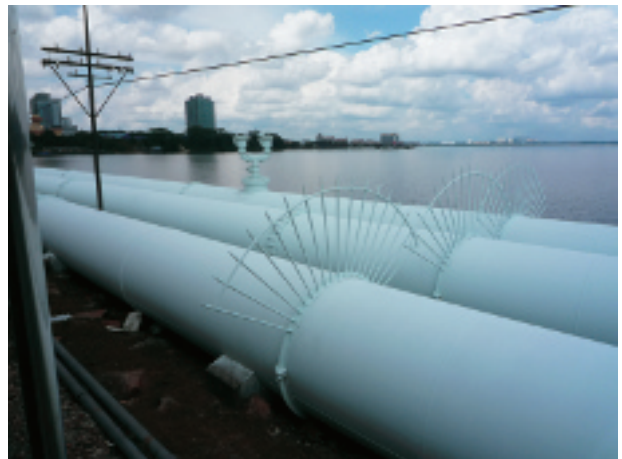
写真-35 ジョホール堤道(コーズウェイ)に敷設された直径約1mの水道管3本を用いてマレーシアからシンガポールに原水が送られる。水道管の向こうにジョホール水道とジョホール=バルが見える。(北東を見る。2011年11月19日)
