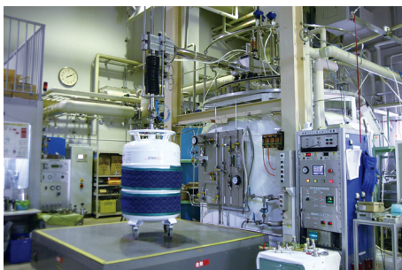
ヘリウム液化機、貯槽及び遠心汲上げポンプ Helium liquefier, storage, and transfer system
