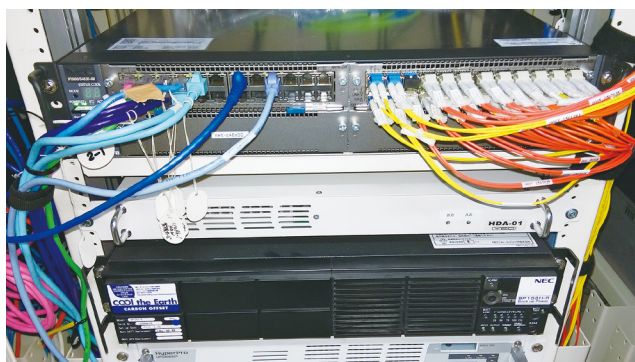
物性研ネットワークの基幹 L3 スイッチ L3 switch: Core network switch of ISSP
