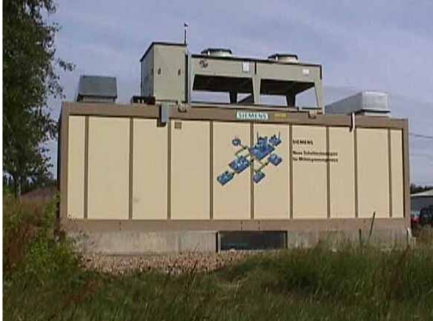
図 容量 2MVA の MVDC の概観
