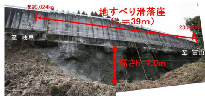
写真 岩稲地区の国道下斜面崩落 (H22. 3. 9)
