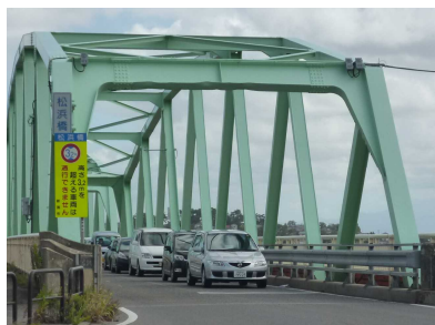
▲現道部(松浜橋)の高さ制限【写真①】
