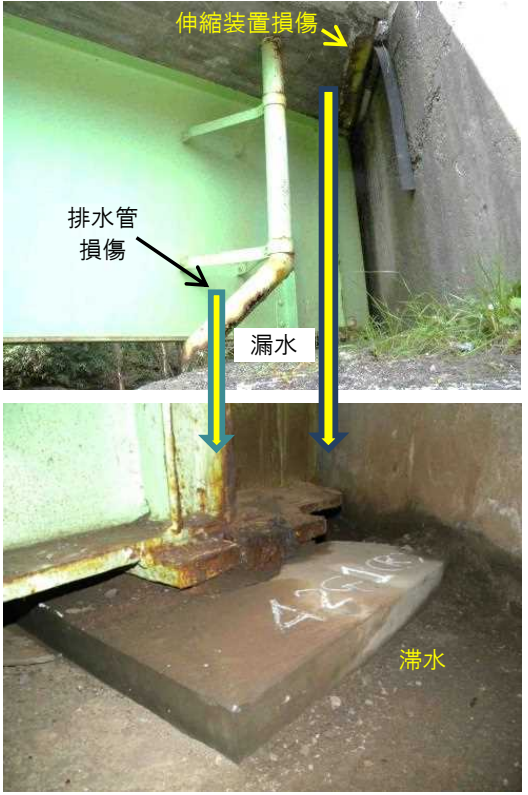
伸縮装置や排水管の損傷による漏水
