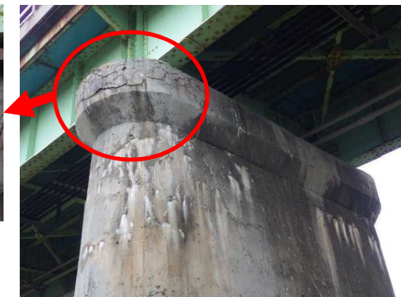
凍害による橋脚の損傷
