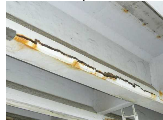
飛来塩分による塩害の損傷
