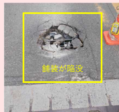
床版の損傷が深刻化、舗装が陥没
