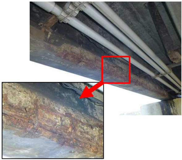
主桁の塩害による損傷
