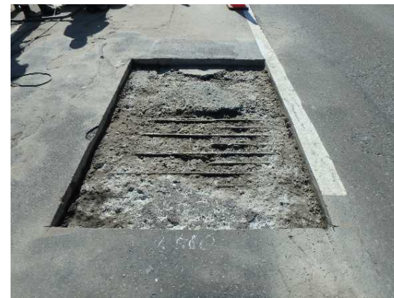
凍害による床板の剥離
