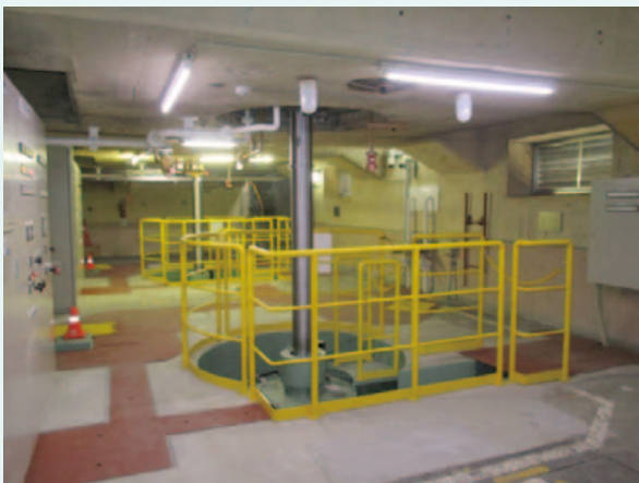
3 柿の沢発電所発電機室（上）、水車室（下）
