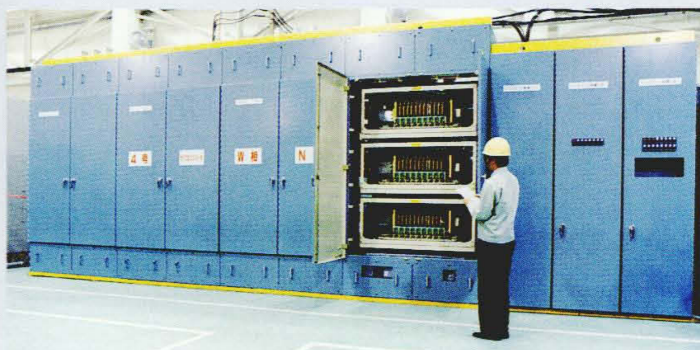
(c) 72 MVAサイクロコンバータ(72アーム中の12アーム)
