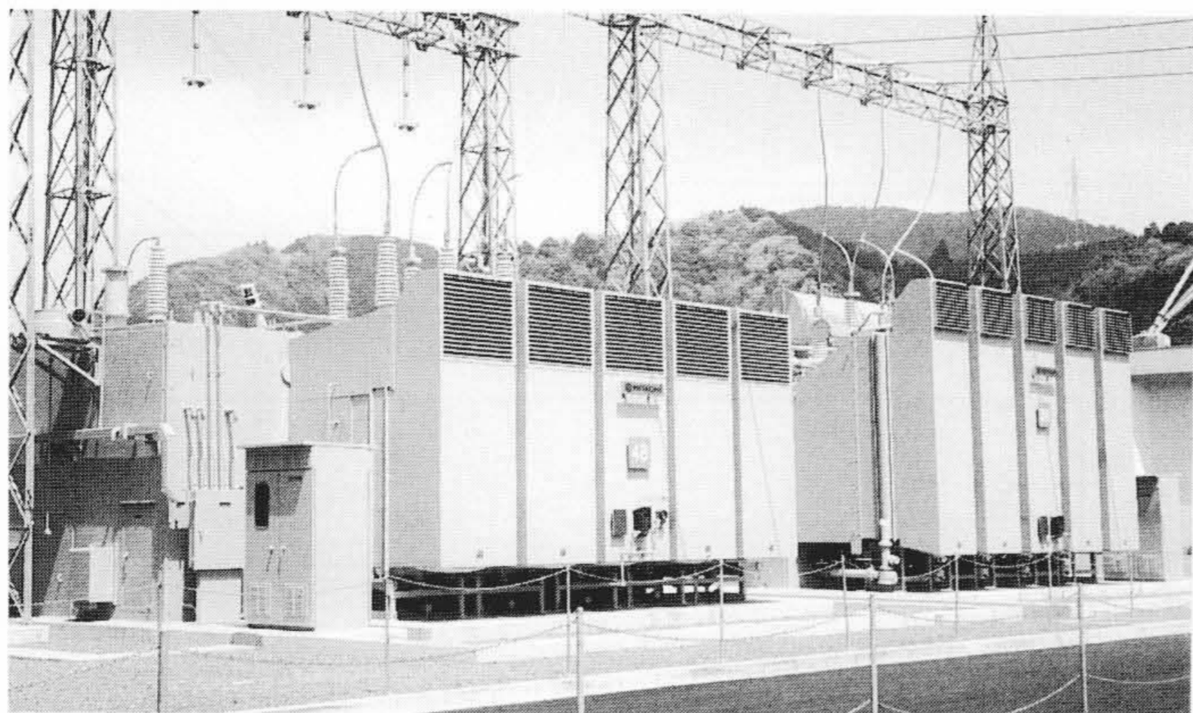
図14 中部電力株式会社安倍変電所に据え付けられた250 MVA変圧器 写真左側が複合絶縁変圧器，右側が油入変圧器である。
