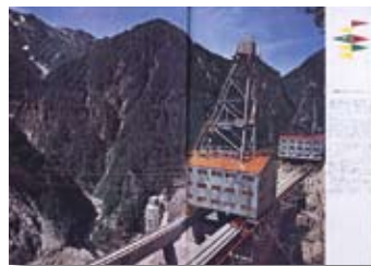
1959(昭和34)年9月号 黒四ダム建設中(4年後に完成)、日立のクレーンが活躍
