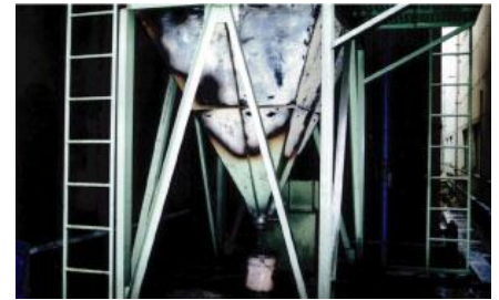
【焼損した集塵機ホッパー部分】
