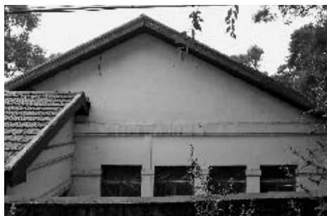
現況写真 8-⑥ 旧拝殿妻面。 桁上端に垂木の痕跡が残る。元入母屋造であったことが確認できる。
