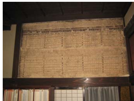
震災で崩れた座敷の壁(竹木舞下地)
