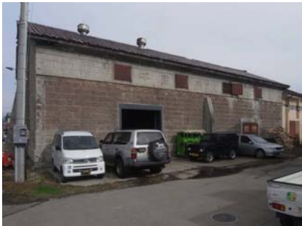
自然変色し、ツートーンとなった外壁
