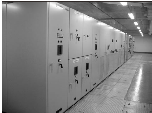
図33 延伸用新設サブ受配電設備（若菜電気室）
