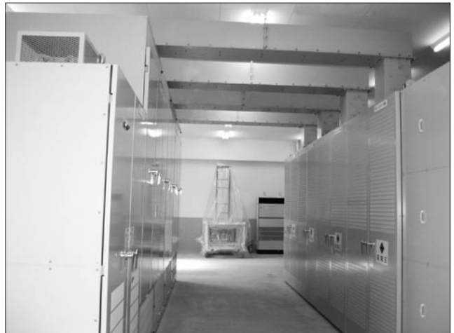
図1 愛知製鋼株式会社向けフリッカ補償装置
