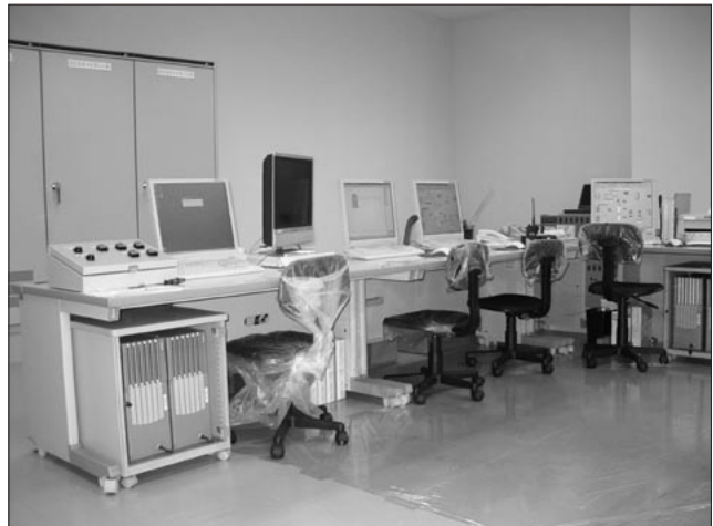
図 13 リサイクルプラントの中央操作室
