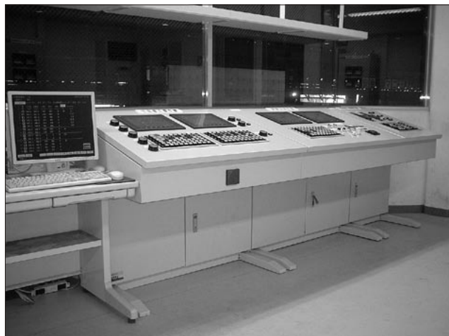
図5 主操作室の設定監視操作デスクとHMIパソコン
