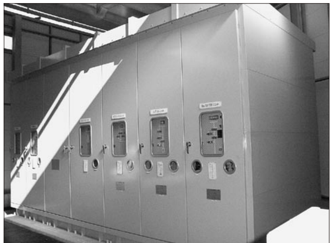
図 18 72 kV ガス絶縁開閉装置
