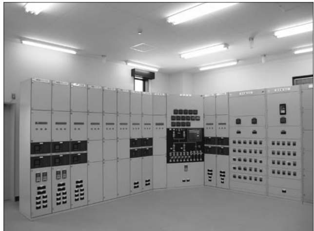
図 17 回線単位形主配電盤
