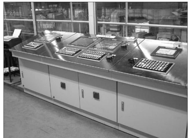
図3 主操作室の圧延監視操作デスク
