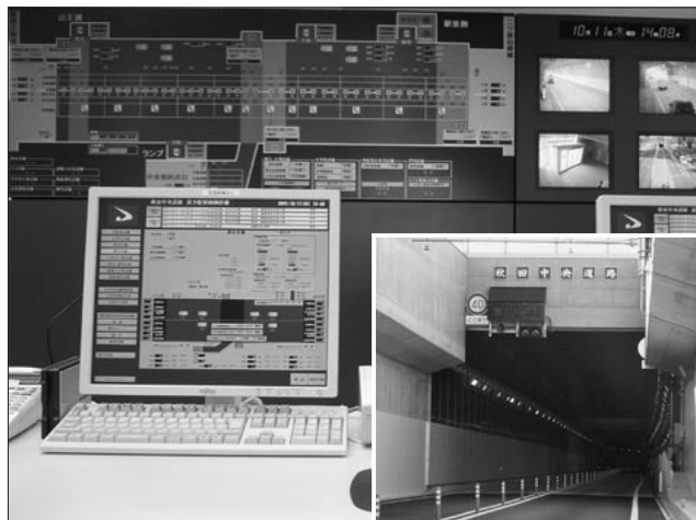
図20 秋田中央道路駅東坑口と中央監視室の運用設備
