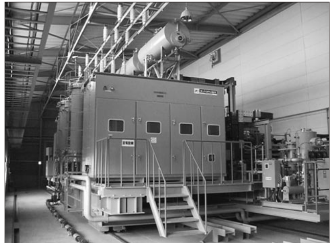
図7 黒鉛化炉用直流電源装置
