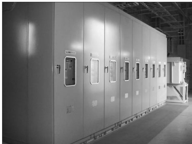
図 14 特高受電棟 C-GIS ユニット
