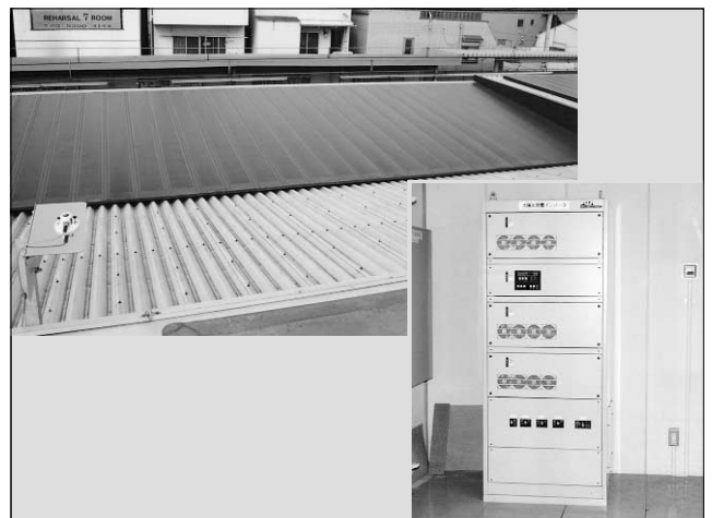
図5 屋根材一体型アモルファスシリコン太陽電池とインバータ
