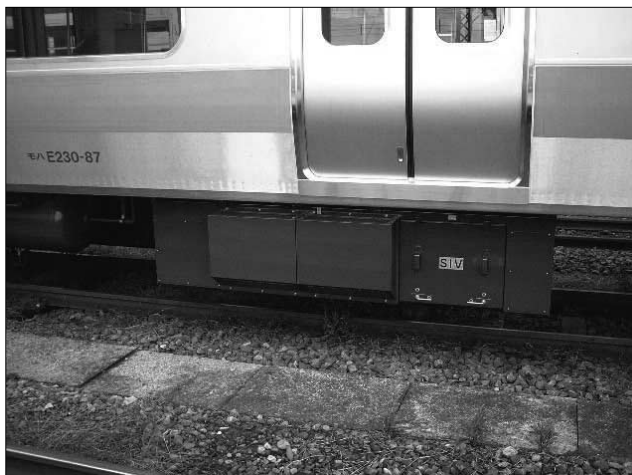
図 8 E231 系直流電車で補助電源装置
