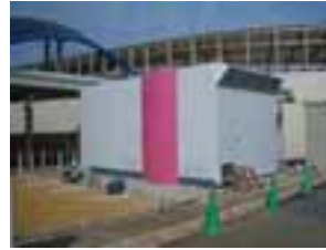
ワンダーサーカス電力館燃料電池
