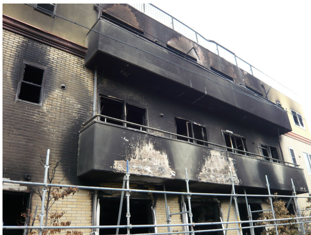
(B) 東側 (7月22日筆者撮影) 図4 火災建物の外壁の焼損状況
