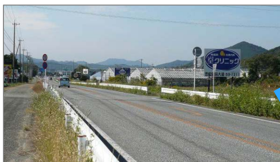
・雑草の繁茂した道路
