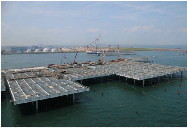
D滑走路棧橋整備状況 写真) 羽田再拡張D滑走路建設工事共同企業体
