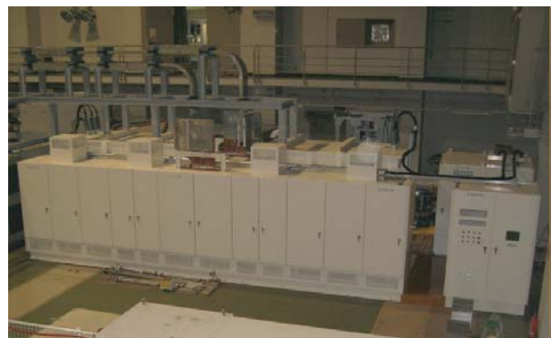
図4 TFコイル電源外観
