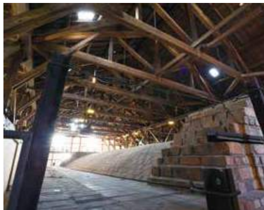
窯の上部。鋼材（レール）とワイヤーでトンネルの広がる力を締め付ける
