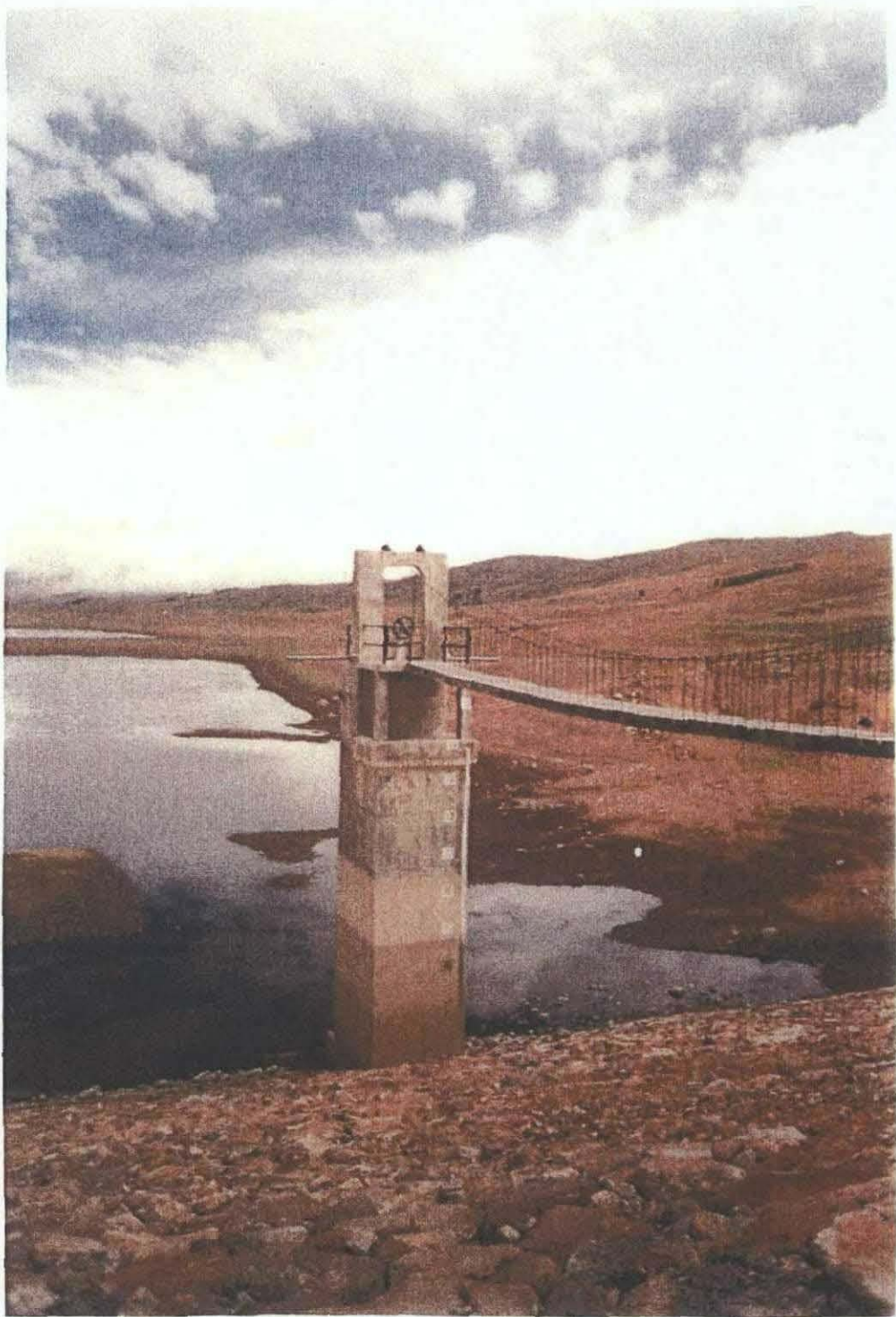
ダム堤体中央部付近に設置されている取水施設
