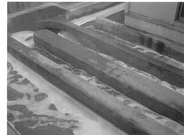
写真3 韓国 冷却水路
