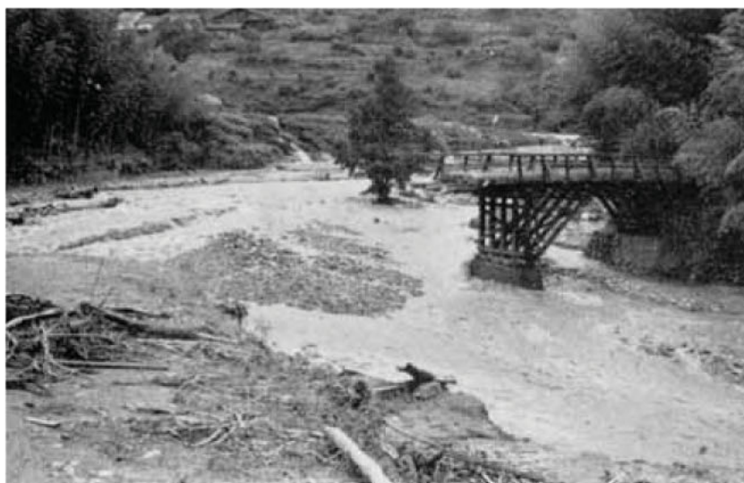
三村道路(中沢村 伊那村 宮田村)から上割に架けられた道平橋は左岸の決壊によって半分に折れてしまった
