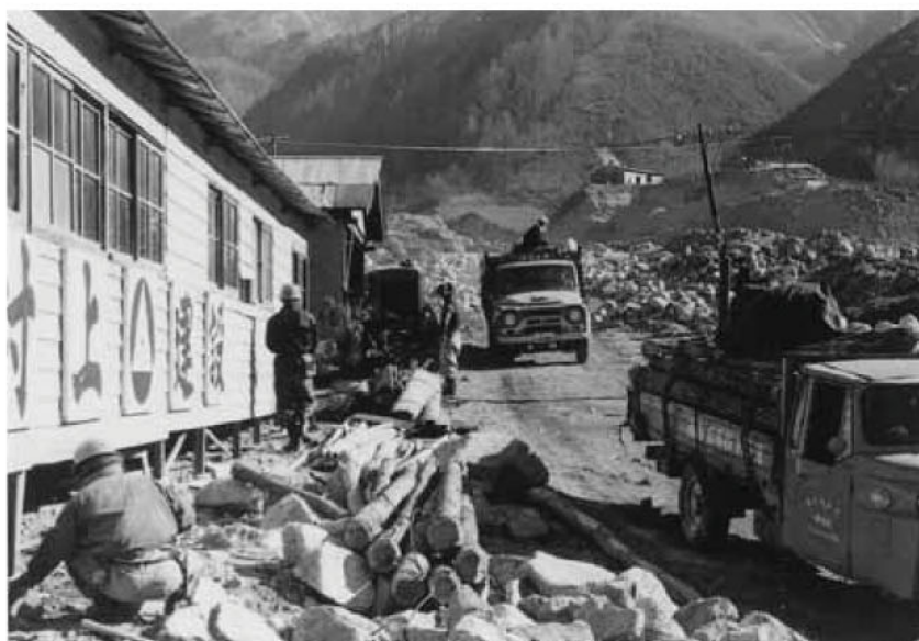
百々目木川で大手建設会社が復旧工事に当たった。村上建設
