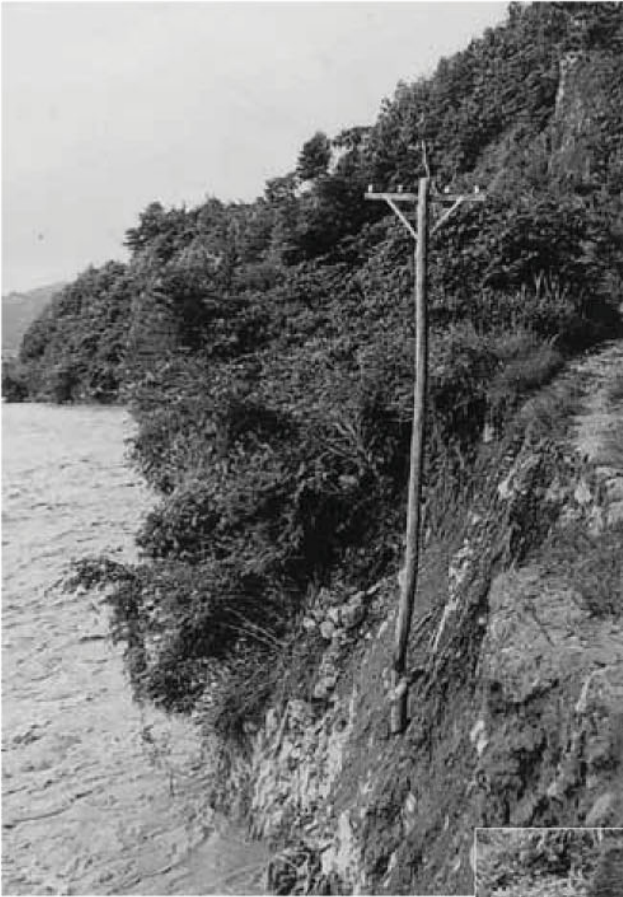
吉瀬除けは道路改良前の徒歩並びに自転車しか通行することができなかった。崩落して危険な個所となった(有線放送の電柱)
