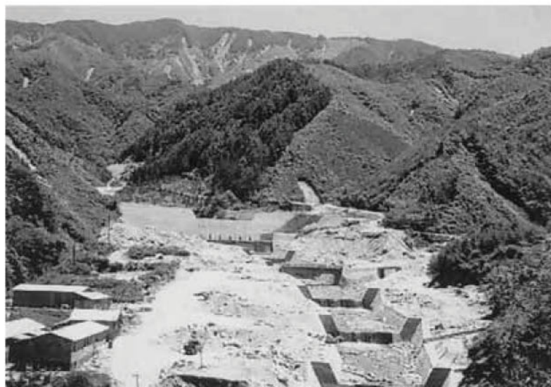
大角地籍の四徳方面へ架けられた橋付近の堤防が完成した
