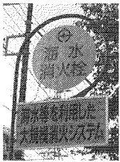
写真-11 海水消火栓
