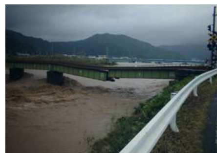
図3 赤羽川橋りょう第1橋脚流失状況
