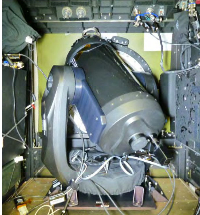
図1.6.1-32 WORFに設置したISERVのイメージ写真（地上で撮影した写真）
