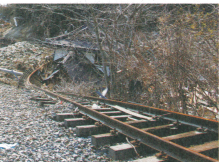
石巻行き電車が停車していた少し手前で、線路は飴のように曲がり、消失。
