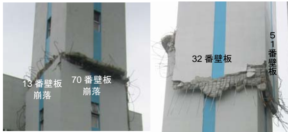
(a) 最大変形時引張側 (b) 最大変形時圧縮側 写真-2 煙突の折損状況
