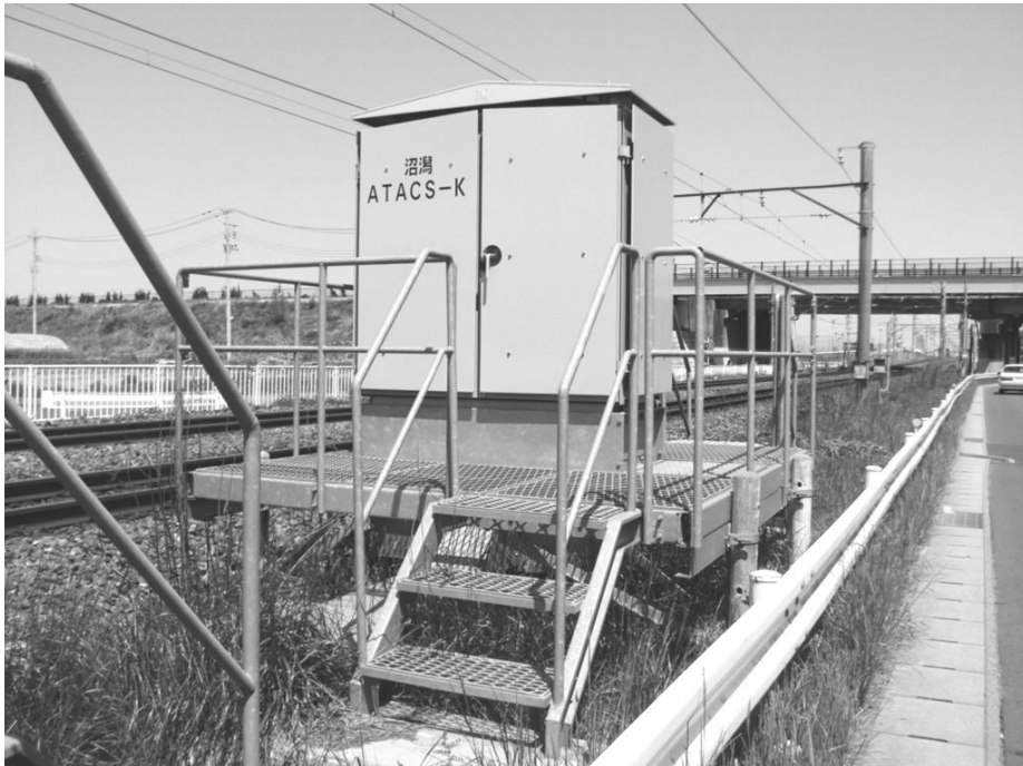
小鶴新田駅付近のATACSの設備
