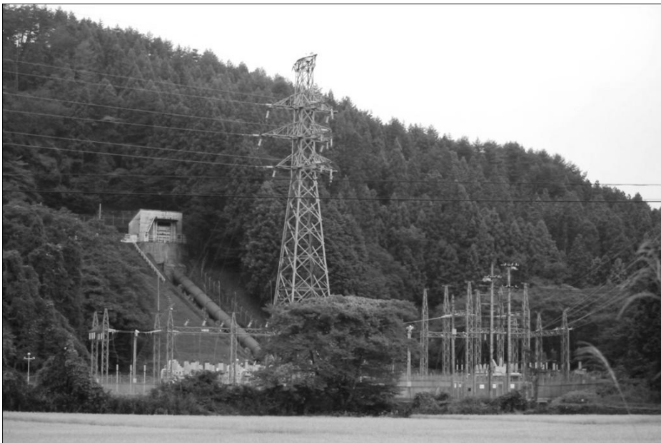
図13 東北電力池月発電所全景(E地点)
