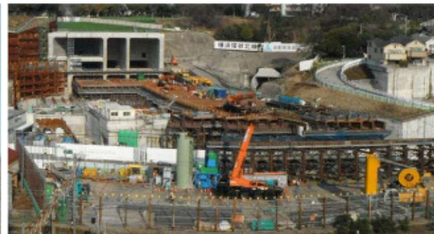
写真③ 生姜JCT(鉄道交差部) (高架橋架設のための構台工を実施中)
