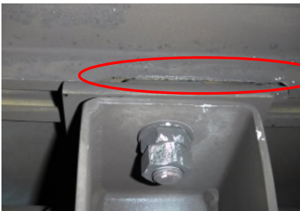
機器吊り用レール ひび割れ個所
