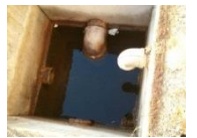
木更津駐屯地の油水分離槽
