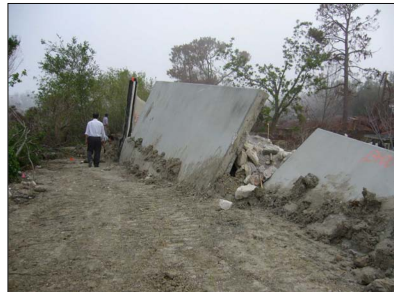
ロンドン通り運河の破堤箇所(下流)
