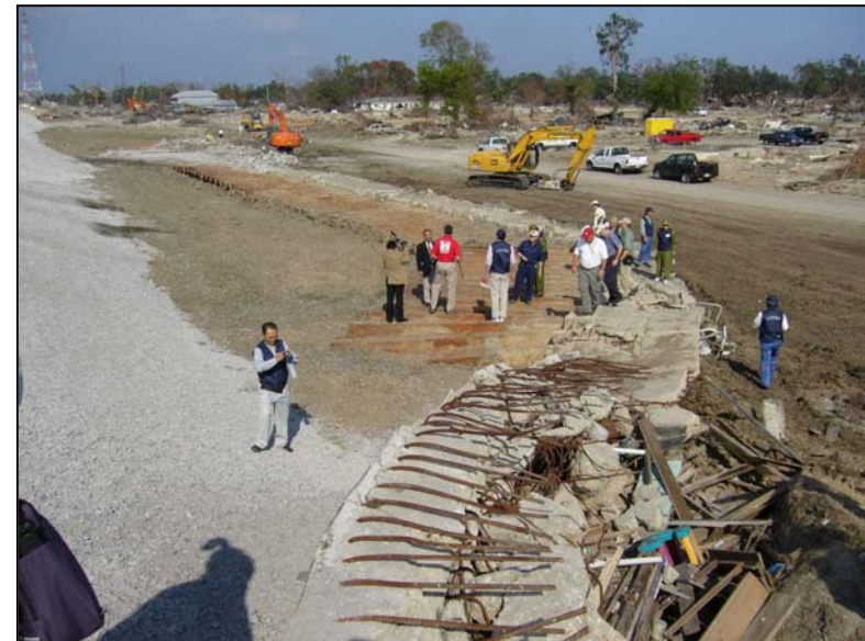
工業運河の破堤箇所
