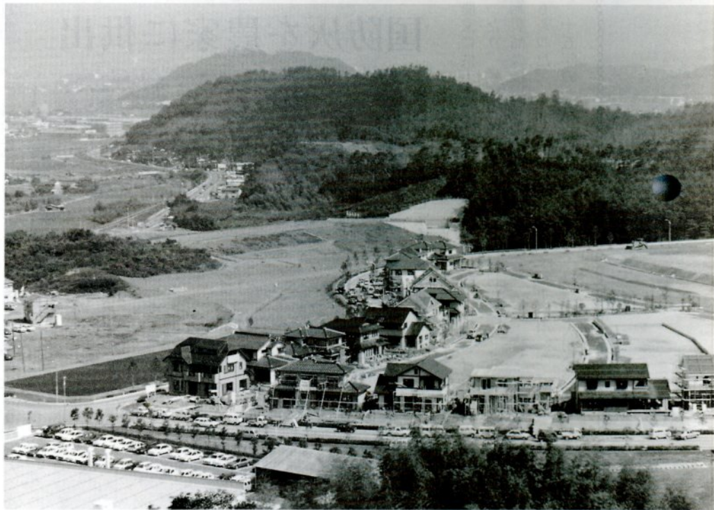
建売住宅の建築が急ピッチで進められている若葉台南6丁目の分譲区域
