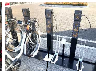
充電装置 ラック
