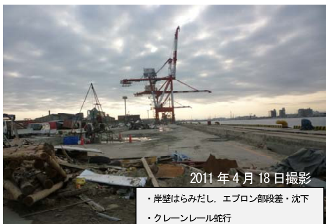
写真-3 岸壁被災状況
