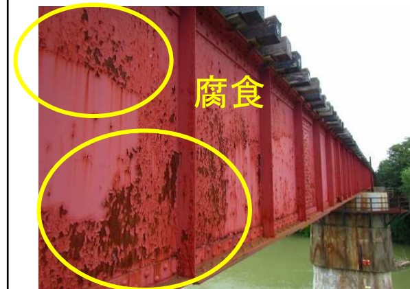
腐食が発生した橋りょう
