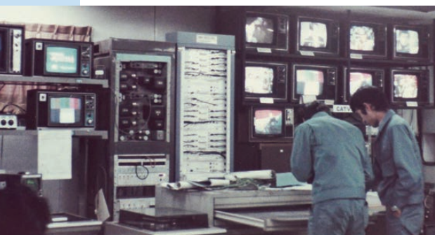
1971年頃の事務所風景、写真中央がヘッドエンド
