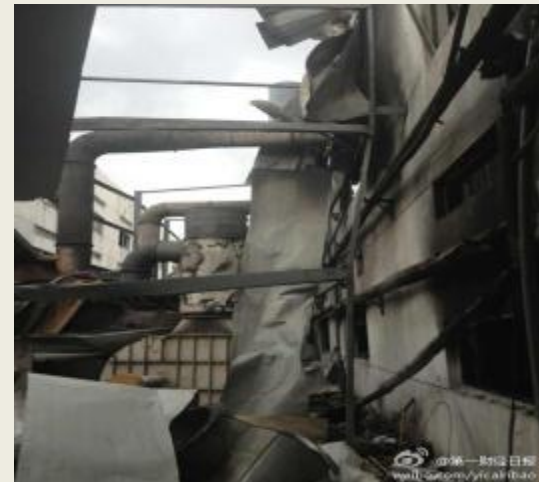
工場外の除塵配管
