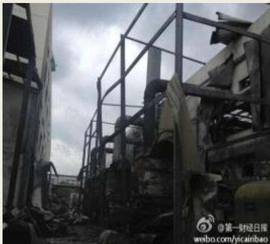
工場外の排気配管
