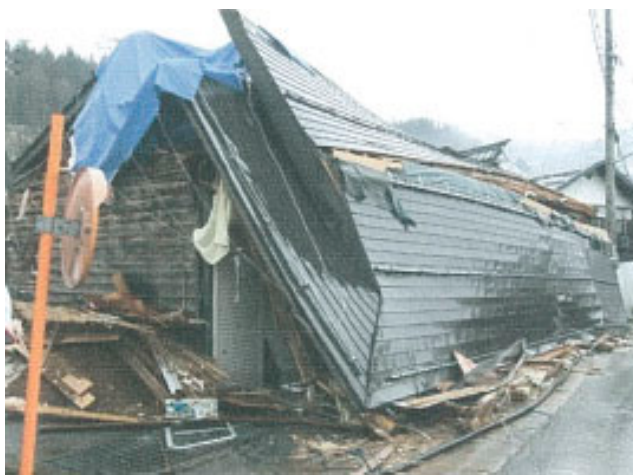
写真3.5-57 栄村第1分団青倉班詰所の被災状況 1)
