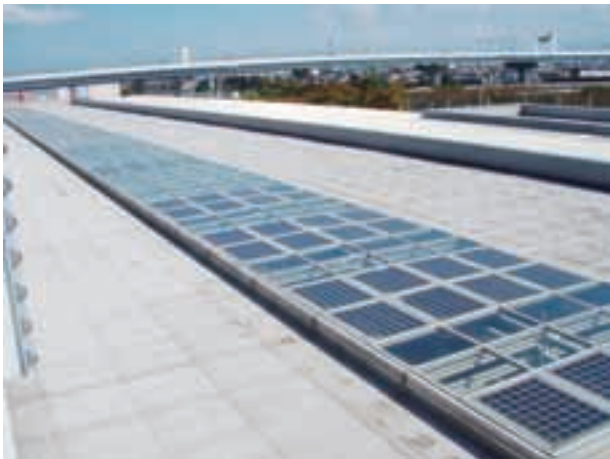
図4 太陽光発電パネル
