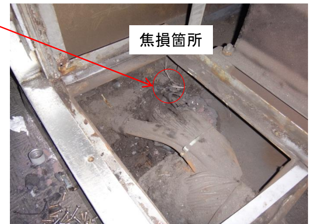
配線の被覆の一部に焦損あり
